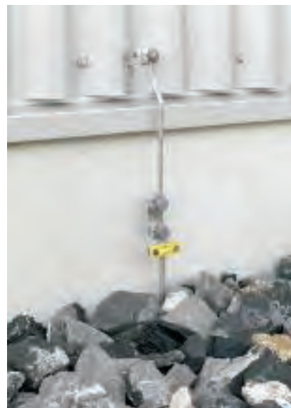
Место разъединения системы заземления вой установки
