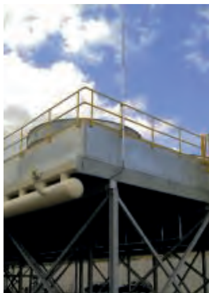
Система изолированного токоотвода во взрывоопасной зоне
