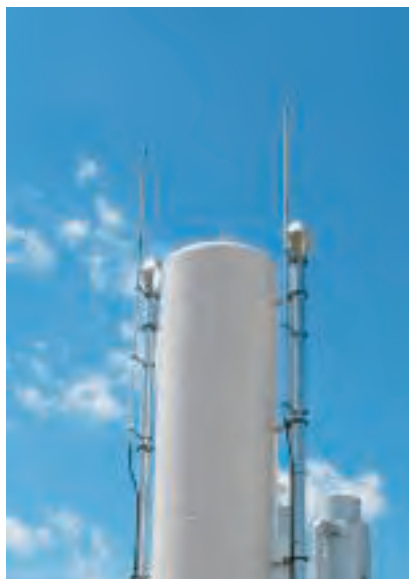
Система isCop® в выхлопной зоне биогазовой установки
