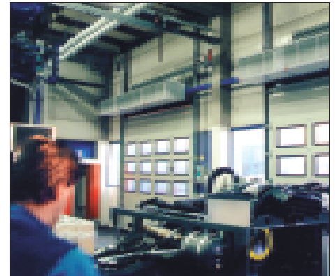
Воздушные завесы, завод "Volvo", Борас (Швеция).
