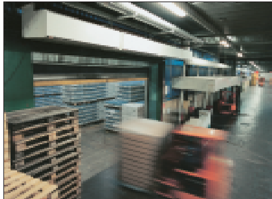
Воздушные завесы, завод "Ramlosa", Аттекулла (Швеция).
