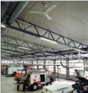
Потолочные вентиляторы, пожарная станция, Гетеборг.
