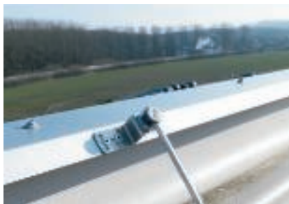
Соединение аттика с системой молниезащиты
